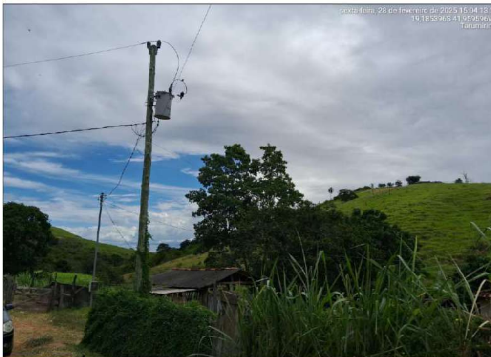
Imagem 26: Benfeitoria transformador de energia 25 KWA.
