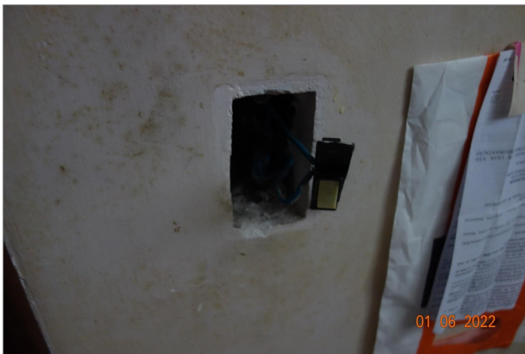
FIGURA 4 – Estado de conservação e padrão de acabamento de interruptor
