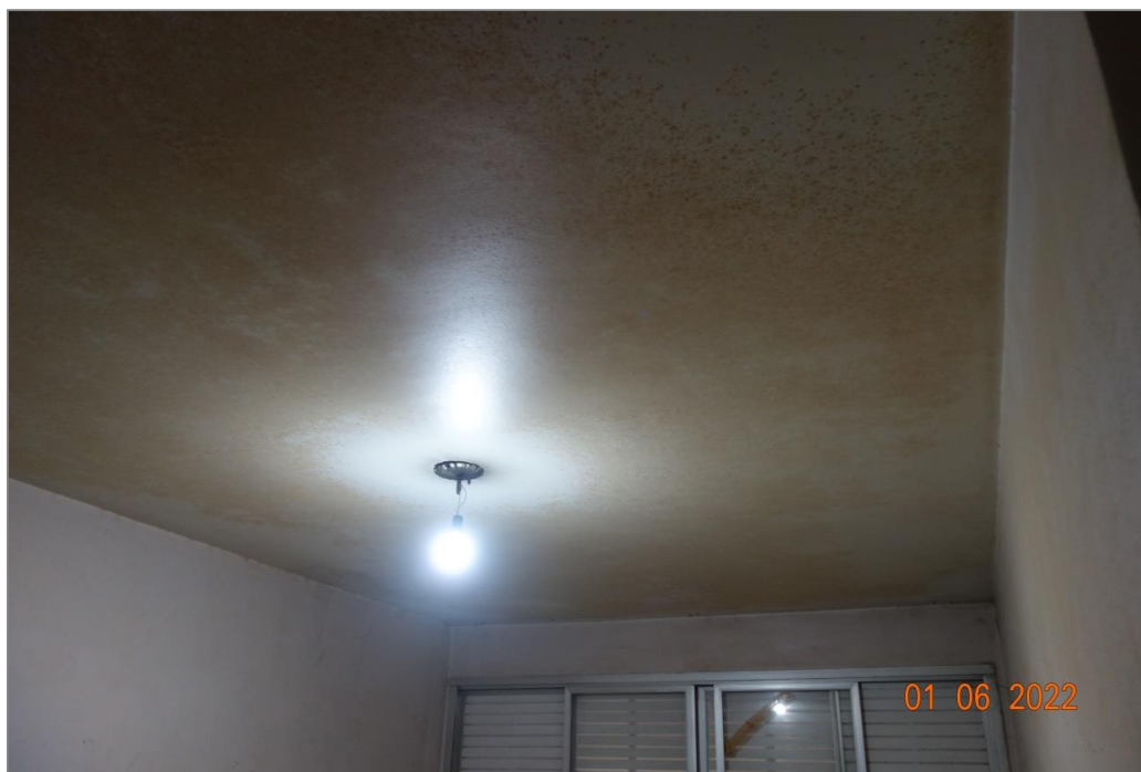
FIGURA 1 – Estado de conservação do teto de um dos quartos
