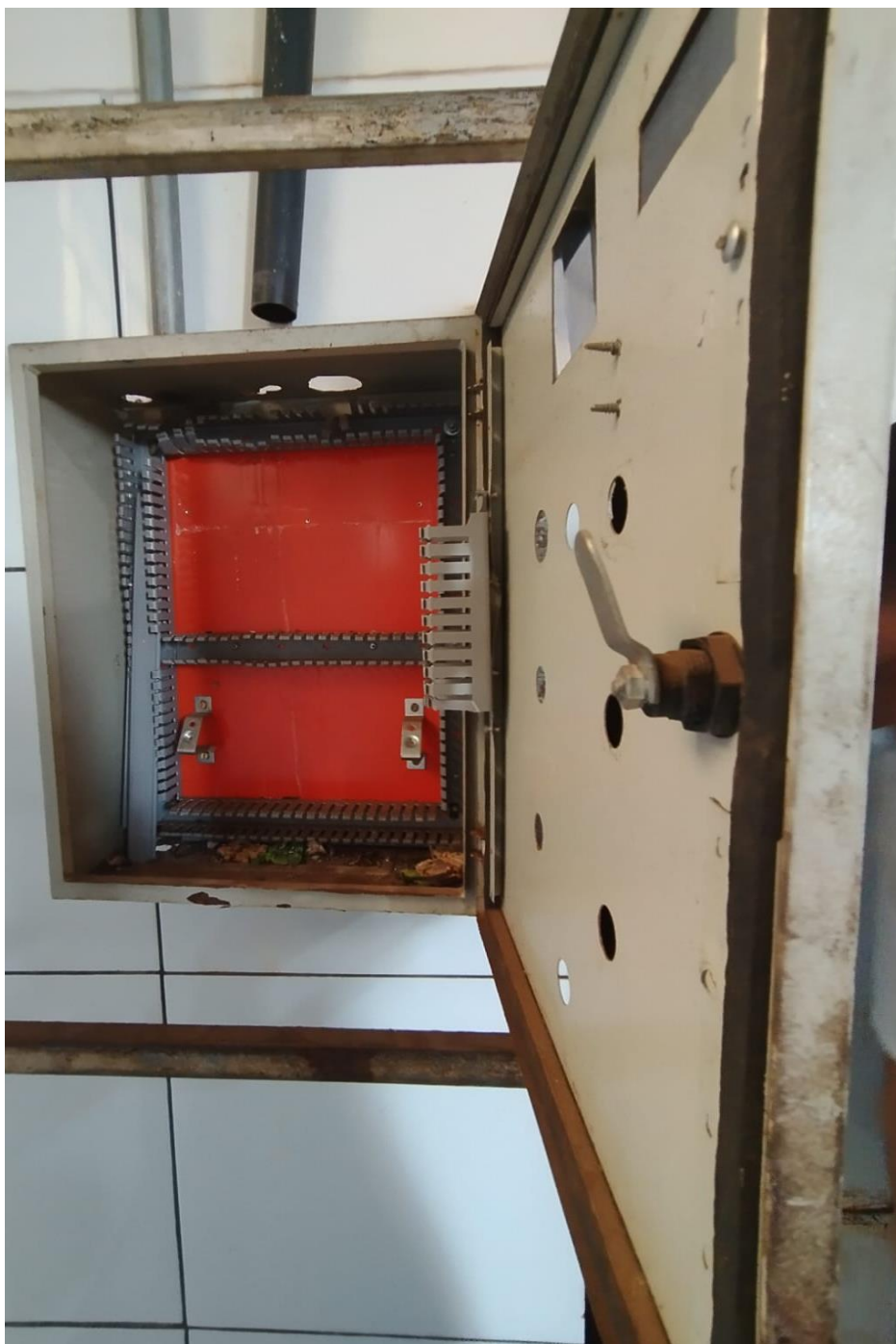
Imagem 10: Painel sem seus componentes elétricos
