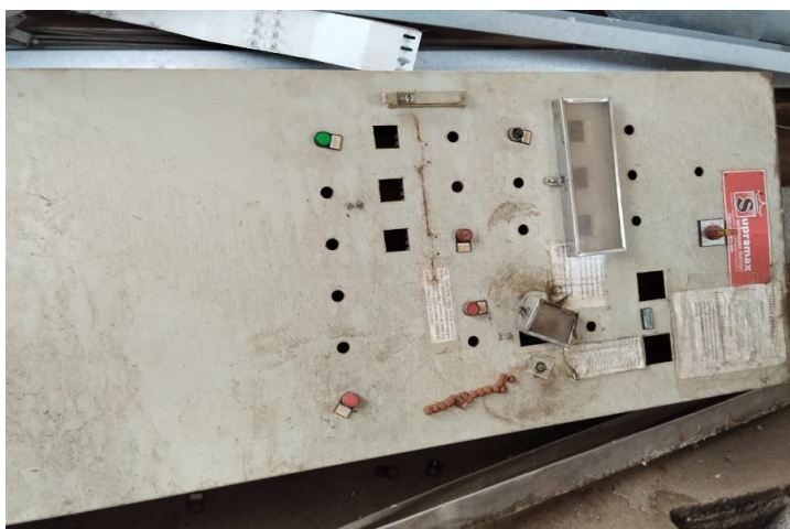
Imagem 12: Painel de acionamento e comando do forno
