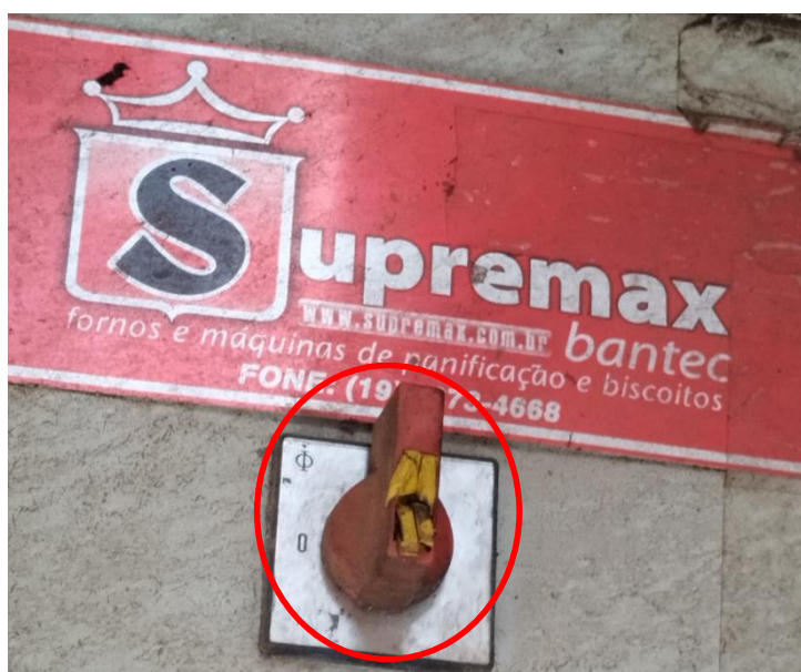
Imagem 7: Plaqueta do Fabricante e Chave Liga-desliga danificada
