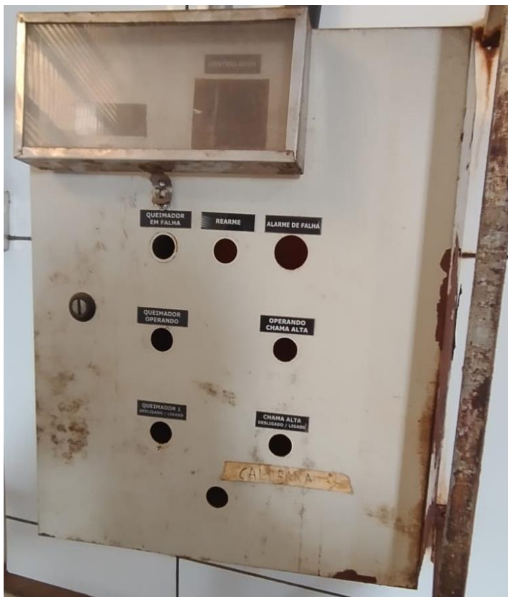
Imagem 9: Painel elétrico do forno com a porta fechada
