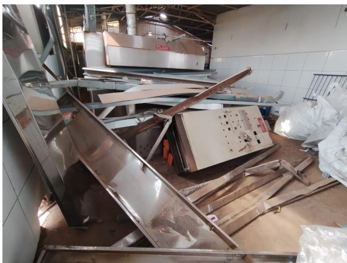
Imagem 11: Parte Frontal do Forno com painel de acionamento e comando, calhas elétricas espalhadas
