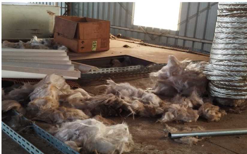
Imagem 15: Lã de vidro e calhas espalhadas (soltas) em cima do forno
