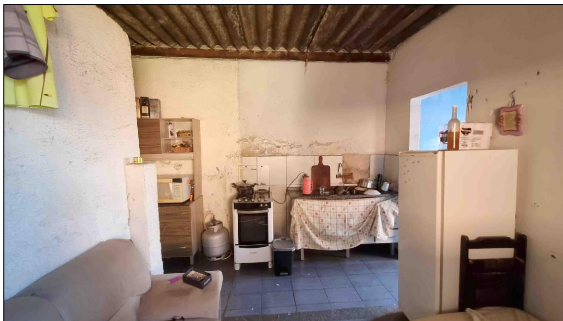
Imagem 36: Cozinha com infiltrações nas paredes.
