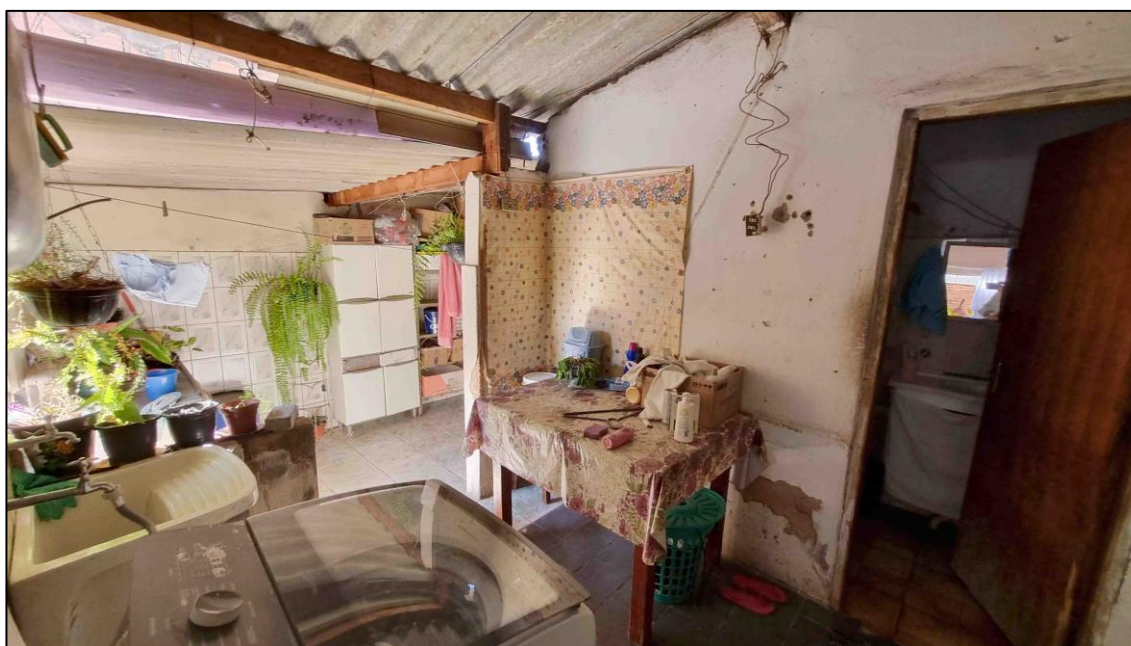
Imagem 26: Área de serviço.
