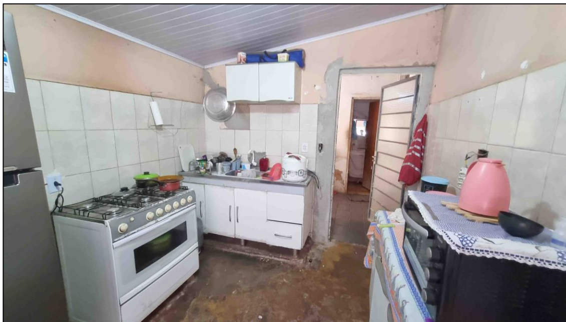
Imagem 25: Cozinha 02 com aplicação parcial de revestimento cerâmico nas paredes.
