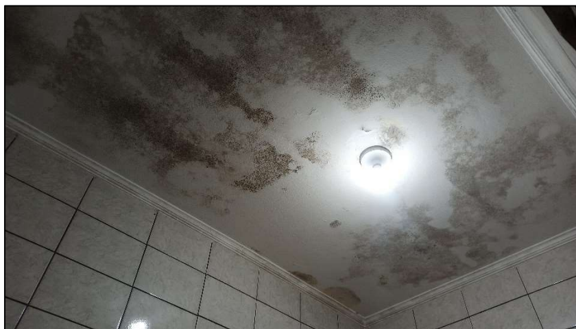
Foto 24. Banheiro da residência dos fundos
