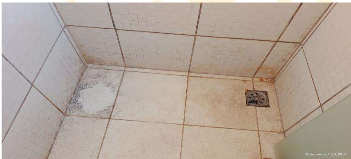
Revestimentos cerâmicos do banheiro estão em péssimo estado de conservação.
