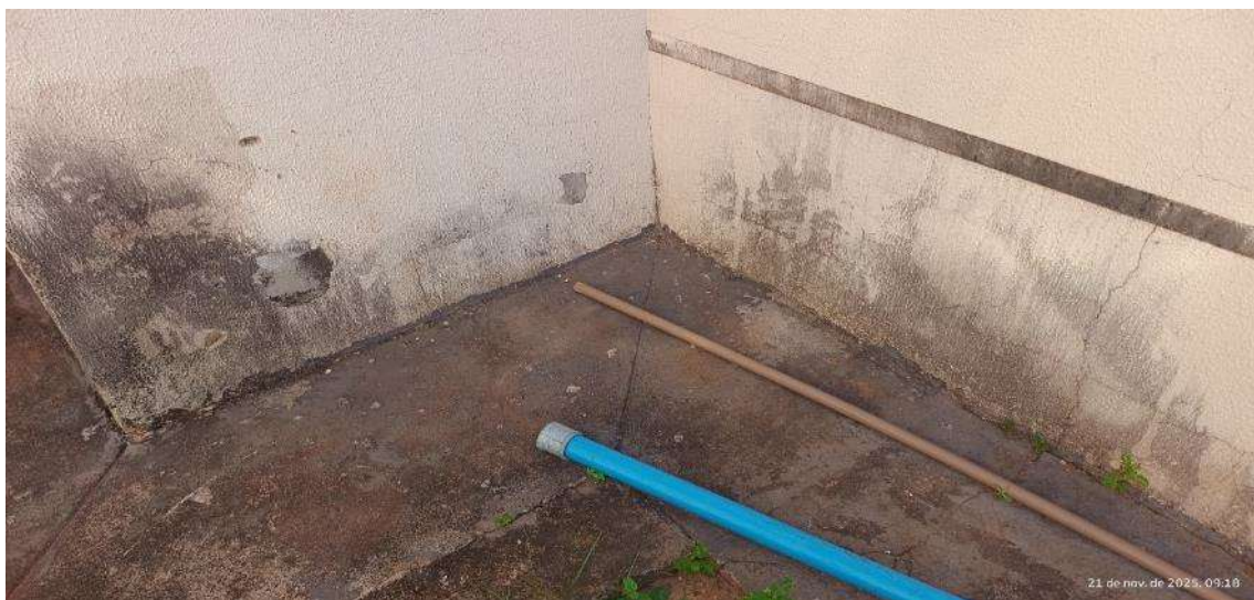
Infiltração ascendentes nas paredes da fachada, mal conservada.
