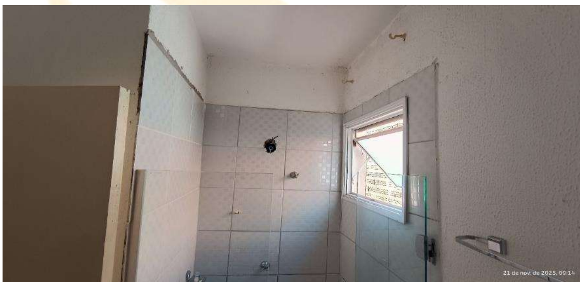
Revestimento cerâmico de parede está mal acabado. O vidro do box está em estado de conservação satisfatório.
