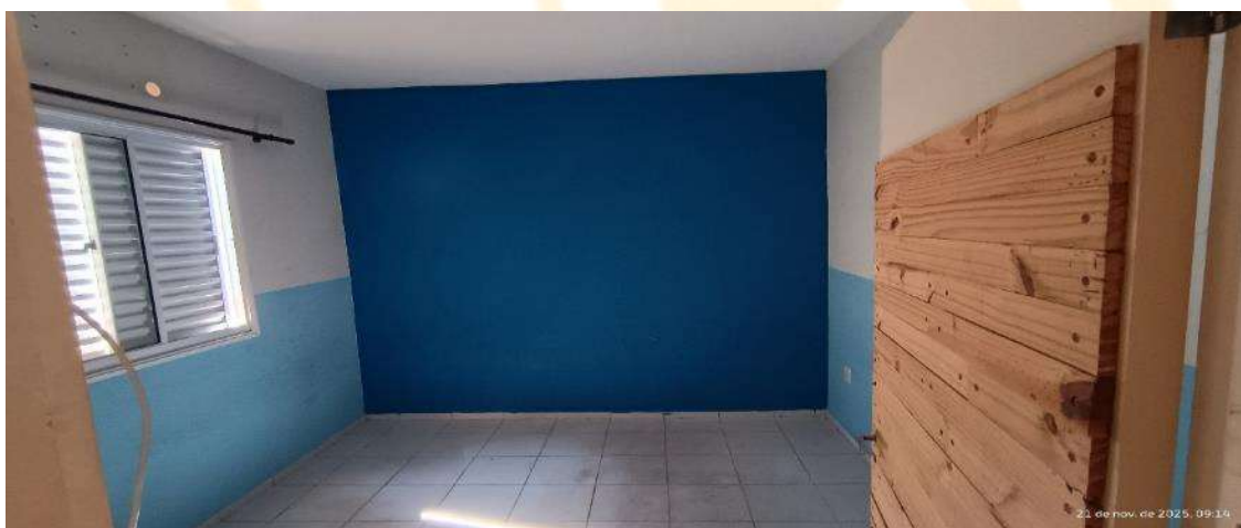
50 Quarto em mal estado de conservação com piso cerâmico e paredes manchados.
