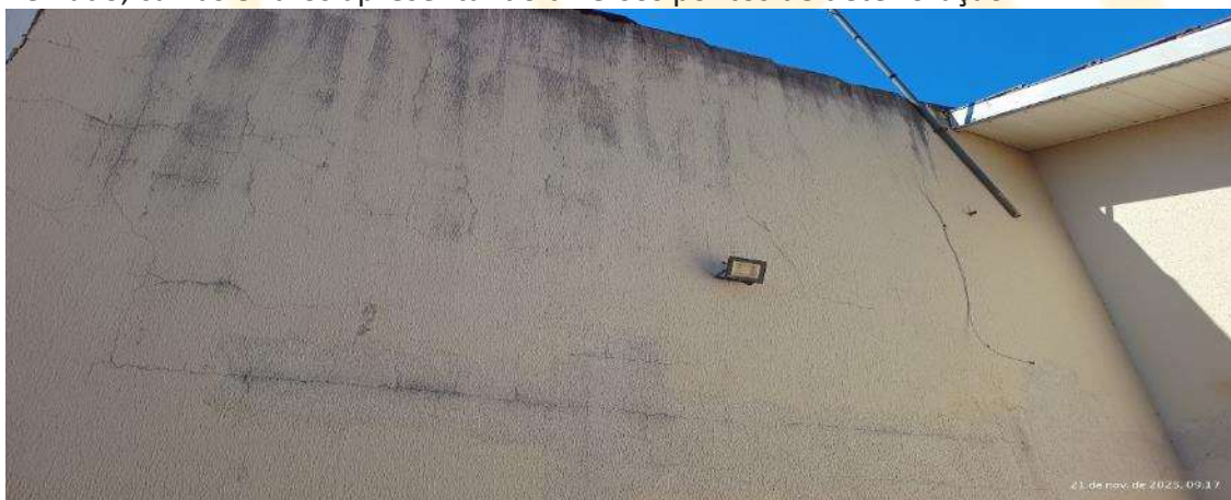
Parede externa do imóvel com revestimento em péssimo estado de conservação.
