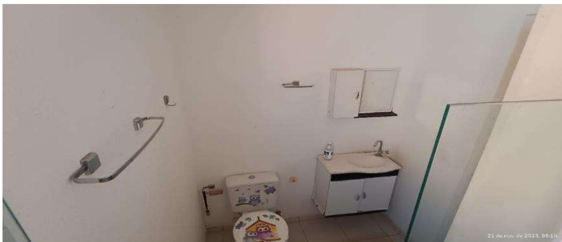
Banheiro com armários impréstáveis. Bacia sanitária em estado satisfatório.
