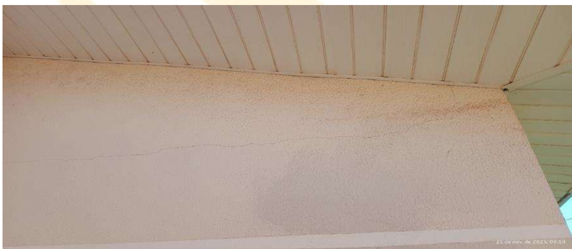
As paredes da fachada apresentam algumas fissuras no revestimento.
