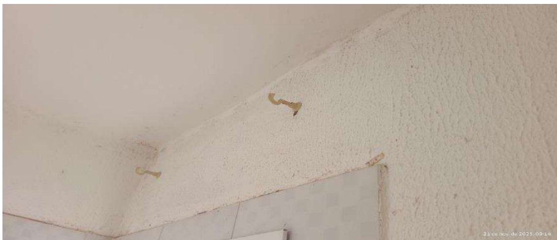
Pintura em mal estado de conservação.
