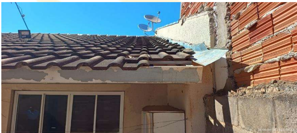
Telhado, calhas e rufos apresentando diversos pontos de deterioração.
