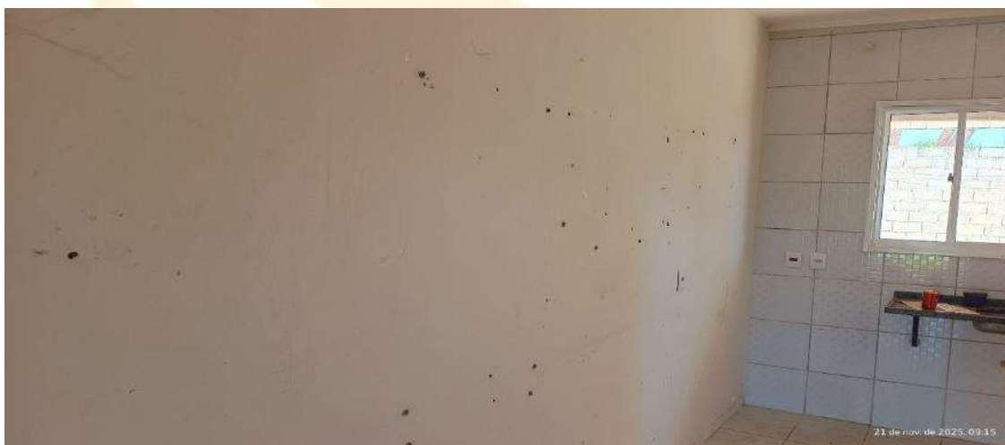
Revestimento de parede da cozinha mal conservado.
