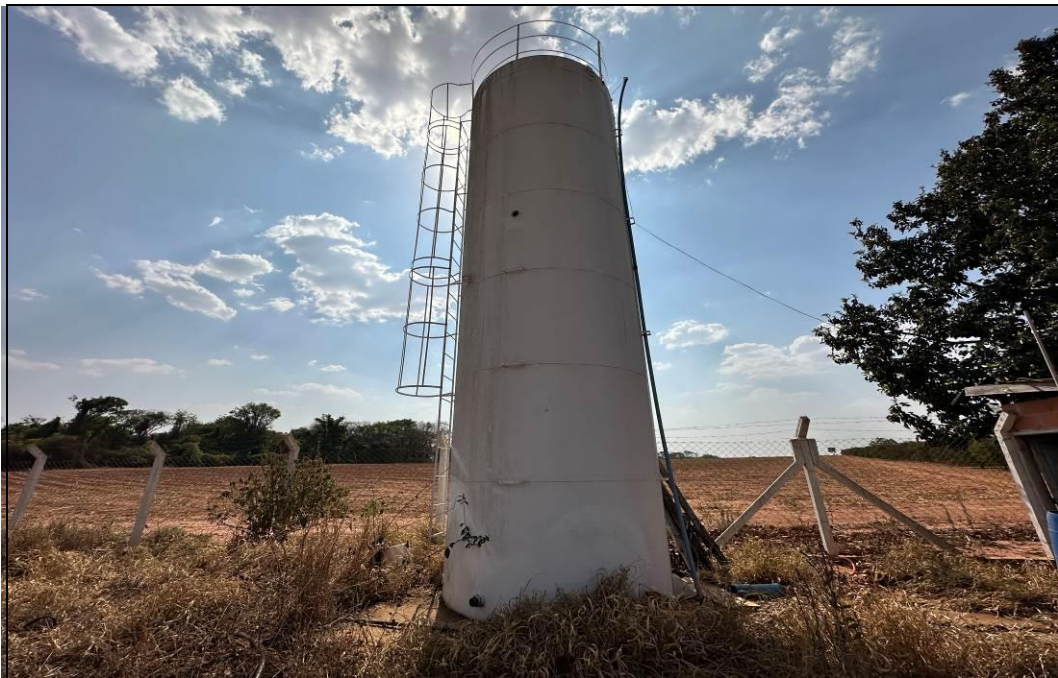
FOTO 13 – Vista da caixa d'água que abastece a propriedade e poço semi-artesiano.
