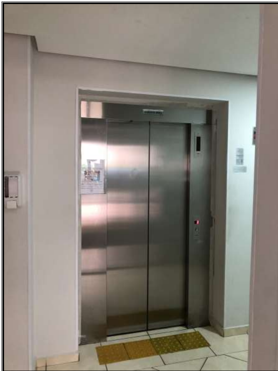
ELEVADOR (Torre A)
